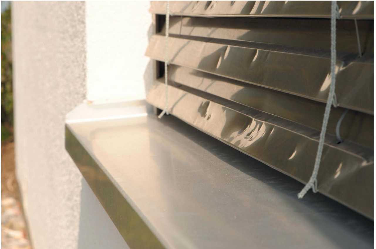
Zu den häufigsten Hagelschäden zählen Beschädigungen an Lamellenstoren. (Lamellen-)Storen, Fassadenmarkisen und Rollläden sind bei Hagel hochzuziehen.
